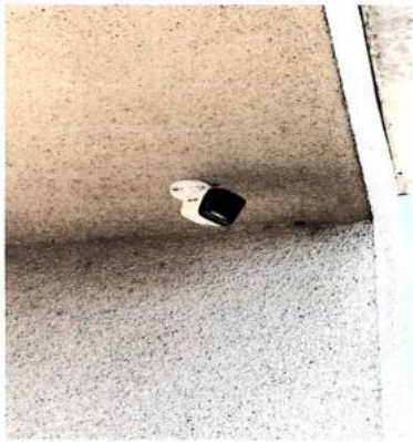
Foto 1: Cámara acceso vehicular condominio (1 unidad).
